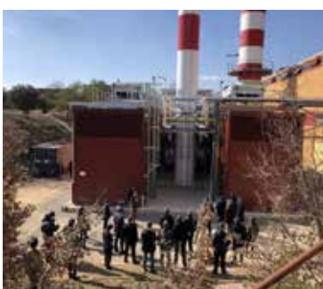
Installation de Cogénération de la chaufferie du centre
