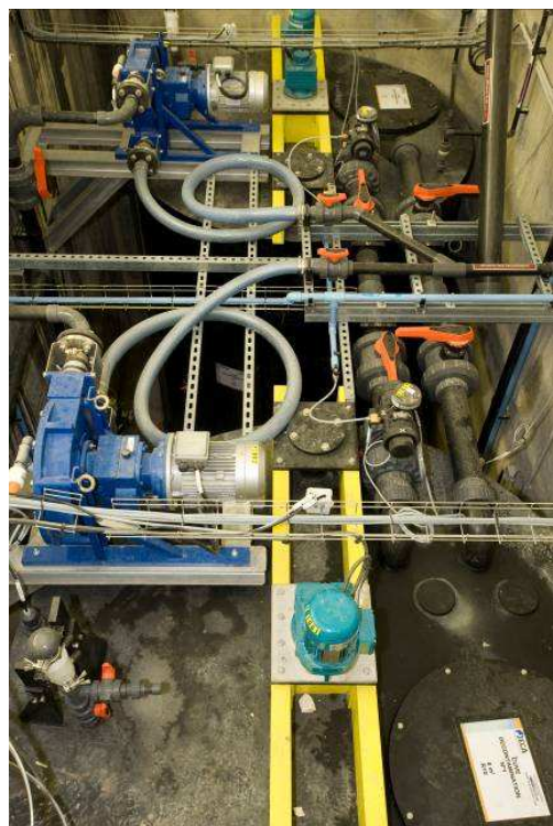
La station de traitement des effluents
