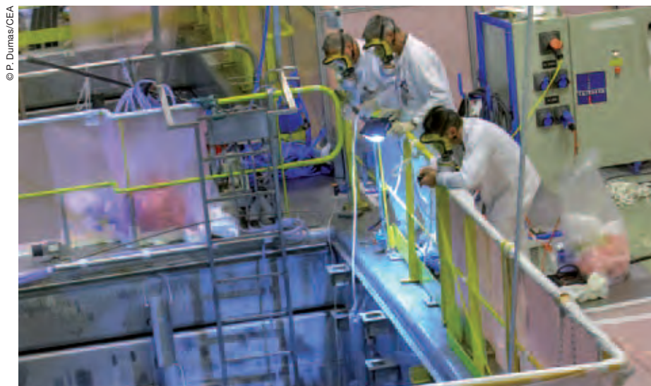
Techniciens immergeant un robot dans une piscine de l'installation MAR 400, en cours de démantèlement.
