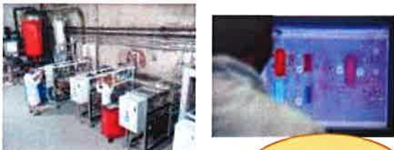
Plate-forme "systèmes thermiques"
