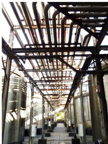
Figure 43 : Vue des tuyauteries et éléments de supportage
