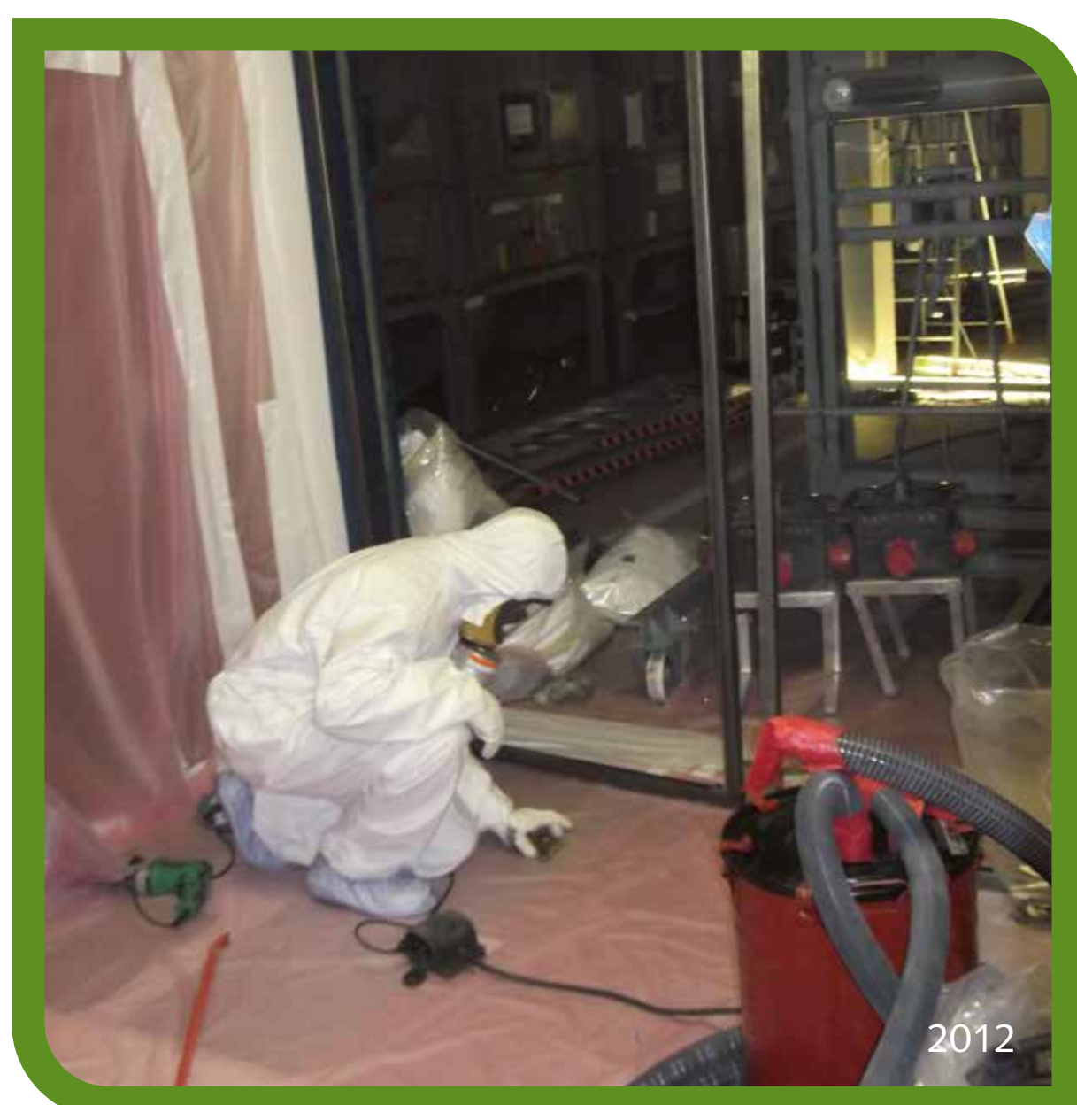
Démantèlement de la salle des filtres du laboratoire de radiométrie n°2 (RM2). Montage d'un sas de confinement avant l'intervention.
