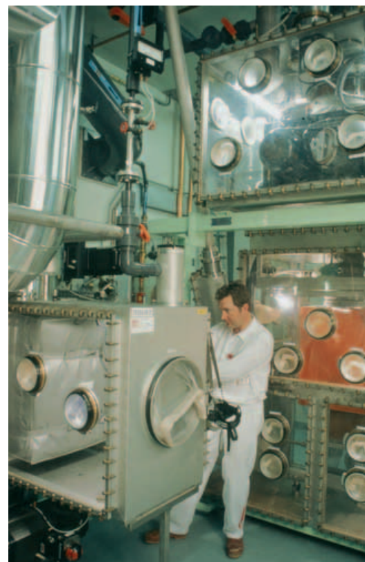
Incinérateur alpha pour le traitement des déchets technologiques du centre de Valduc [Côte-d'Or] de la Direction des applications militaires du CEA.
