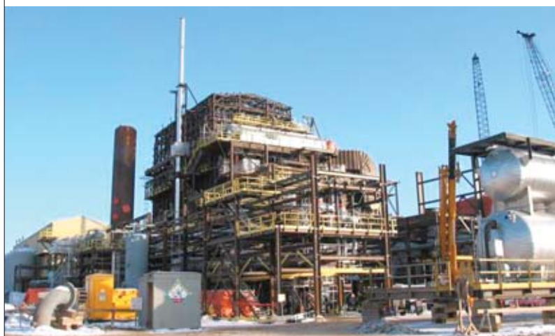
L'unité de vaporeformage construite par Technip pour Syncrude Canada. En une seule ligne, elle produit 223 000 Nm 3 /h d'hydrogène et, en outre, 75 MW d'électricité.
