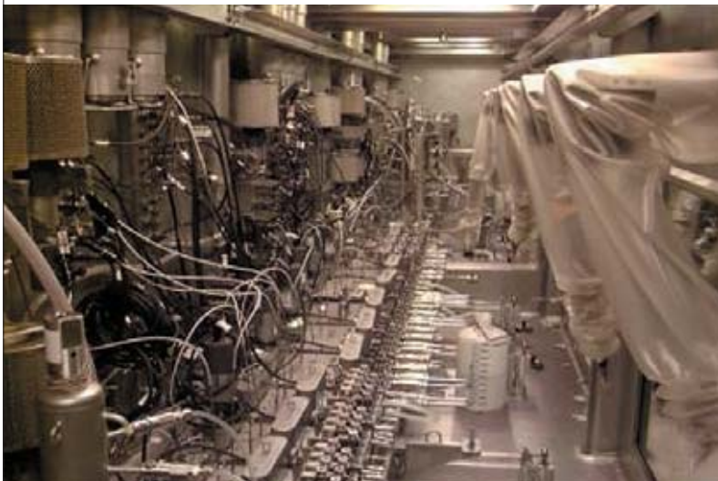
Équipements d'extraction dans la Chaîne blindée procédé (CBP).
