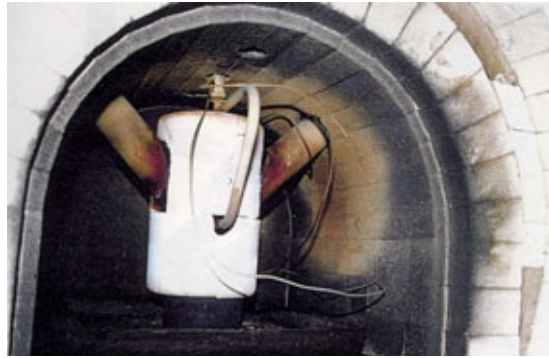
Vue du système de traitement des gaz d'incinération dans le four de la Maquette de vitrification des déchets par plasma (MAP). Cette maquette, implantée dans l'installation Chicade au CEA/Cadarache, est conçue pour l'étude de la répartition des radionucléides bêta-gamma entre le vitrifié et les émissions gazeuses lors du traitement de fusion plasma d'un déchet, dans des conditions représentatives de la réalité industrielle.
