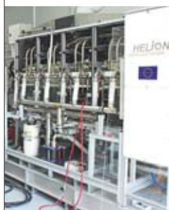
Plateforme expérimentale MYRTE (Corse) : la pile à combustible.
