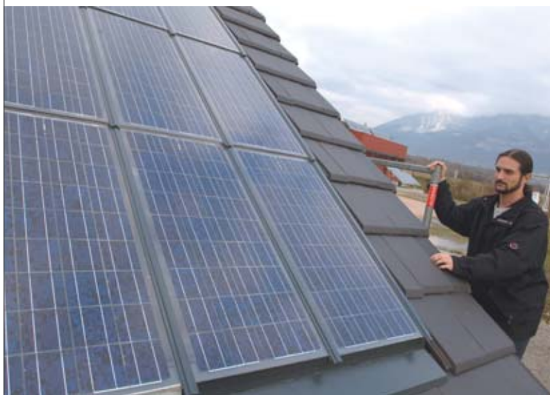
Capteurs solaires photovoltaïques intégrés en toiture (Ines).
