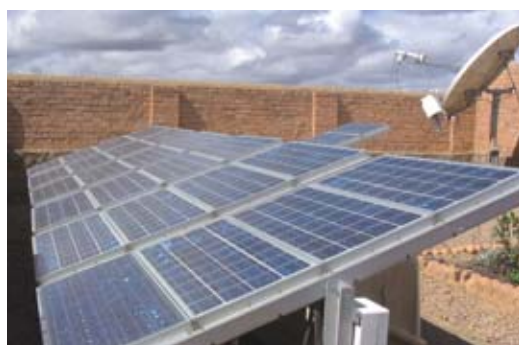
Cette station sismique à Madagascar fonctionne de façon autonome grâce à des panneaux solaires et une antenne parabolique VSAT.
