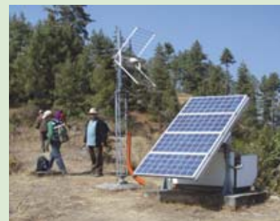
Système d'acquisition et de transmission des données à la station GPS permanente DAMAN installée au Népal.
